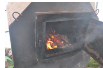
90cmの丸太が入る薪ボイラー。
