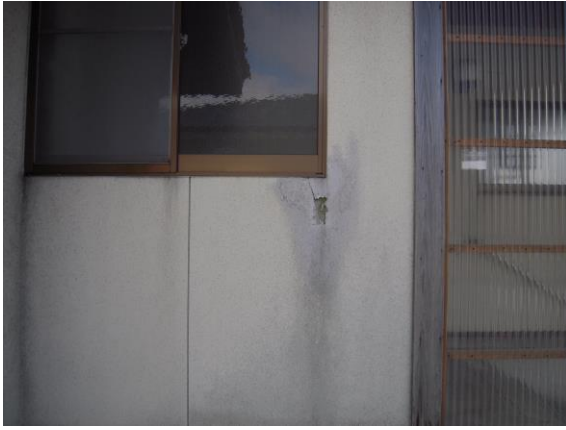
2号棟外壁の破損箇所
