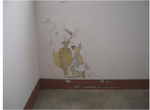
階段室内壁塗装の剥離
