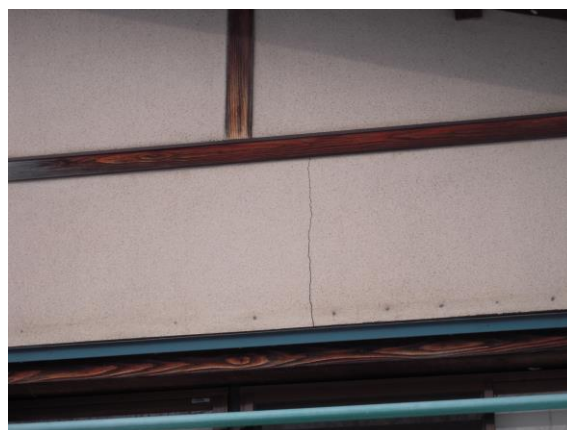
2号棟外壁のクラック
