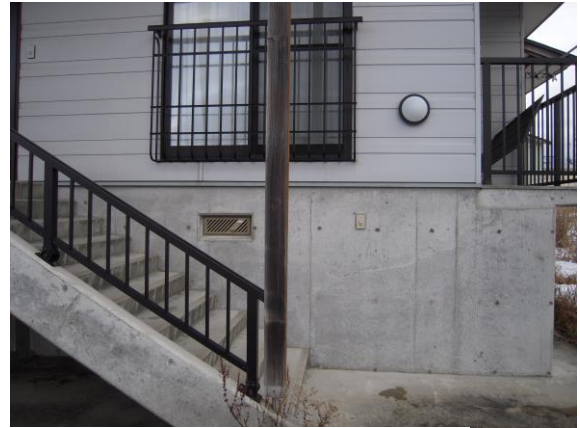
木柱の塗装の剥離
