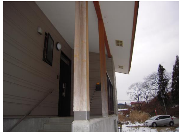
木柱の塗装の剥離
