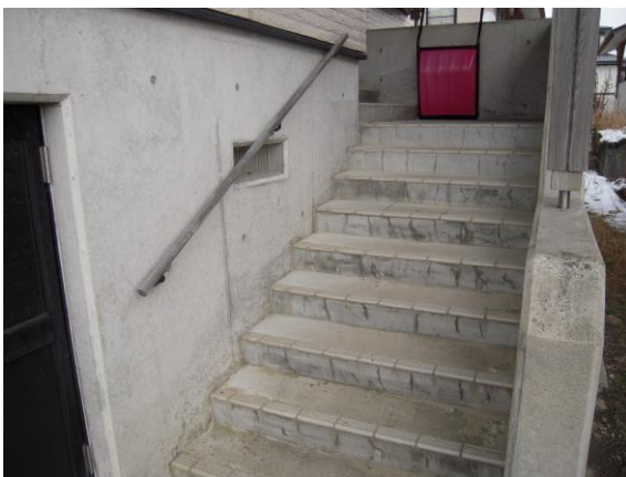
階段手すりの塗装剥離
