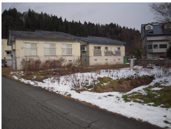
住棟屋根の錆
