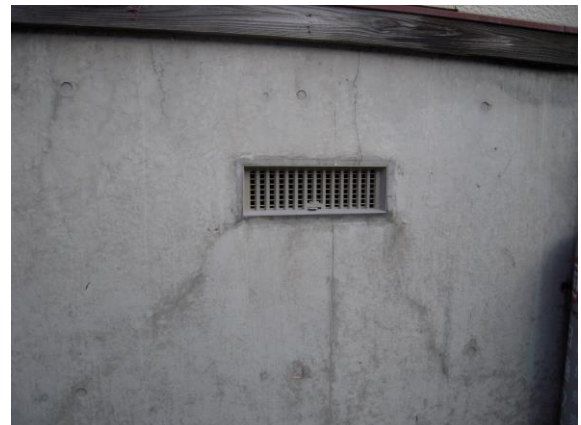
1号棟基礎のクラック
