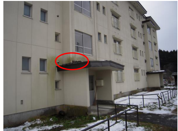
外壁塗装の剥離
