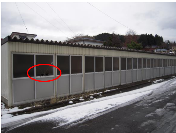
物置ガラスの破損
