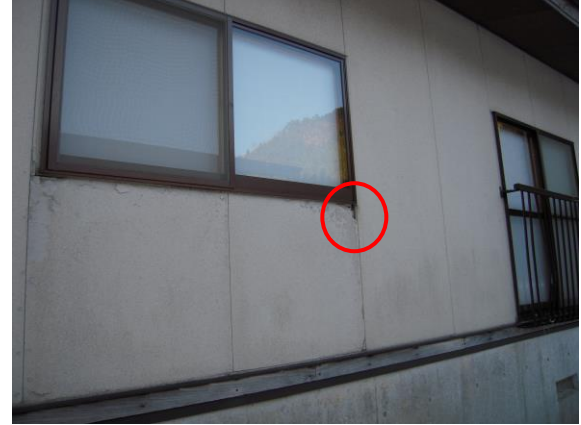
3号棟の外壁破損
