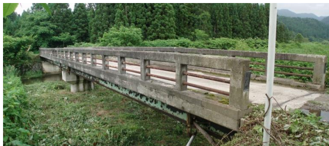
写真 5-1 コンクリート製防護柵
