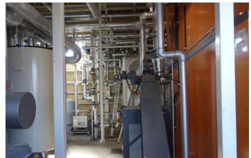
バイオマスボイラ施設内
