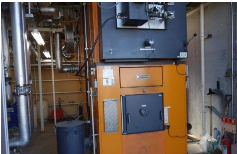
バイオマスボイラの外観
