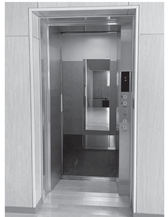
▲大堀小学校に設置されたエレベーター
