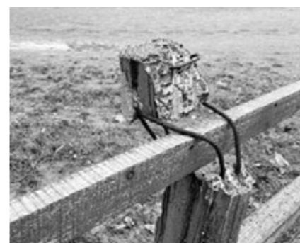
▲馬柵は一部鉄骨がむき出し
