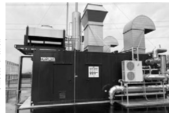
▶飯豊町で発電開始したガス化施設の一部
