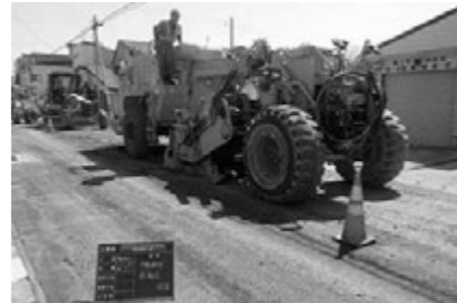
▲向町商店街の道路補修前
