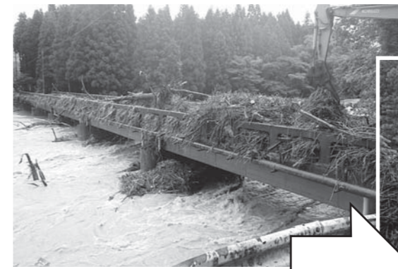
▲大堀 白山橋 (被災時)
