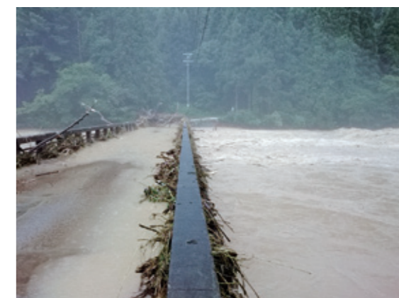
平成30年の豪雨災害時の白山橋
