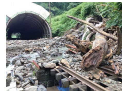
瀬見温泉～東長沢間 土砂流入箇所
